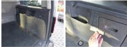
Sliding door R, Bad repair, P - Check
